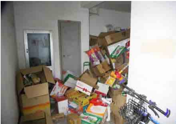
被堵塞的“生命通道”
